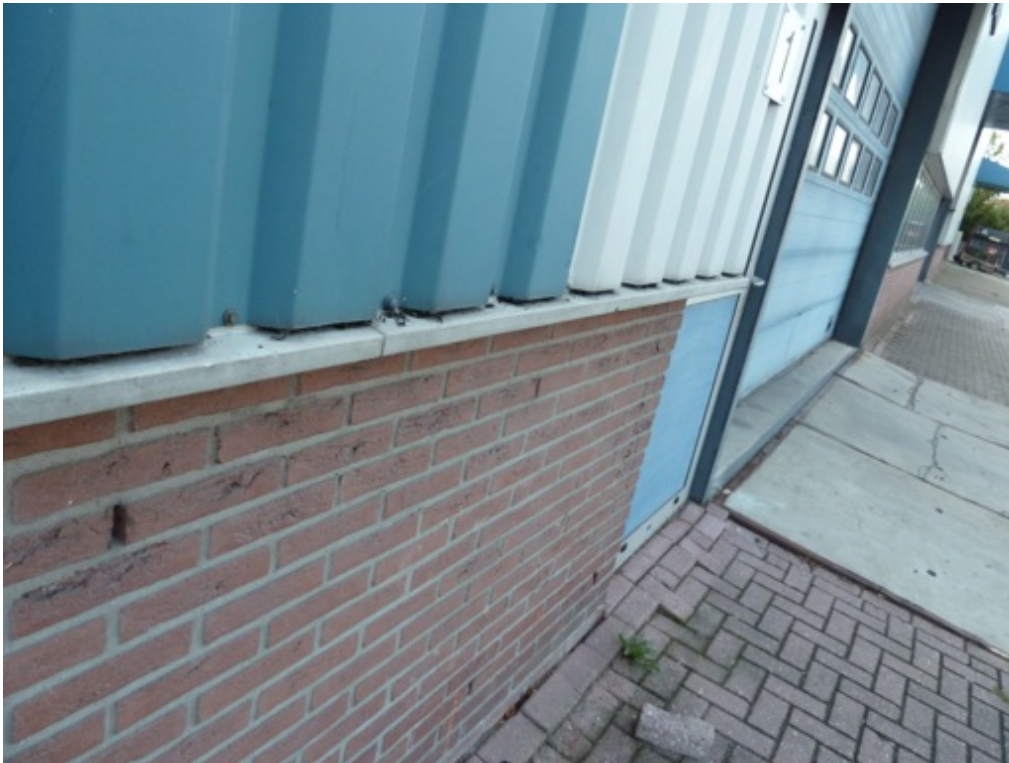
Bedrijfshal aan Klaas Fuitestraat met open stootvoegen en beplating
