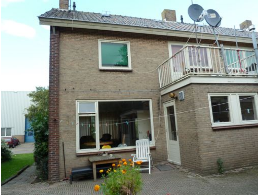
Oosterbrugstraat 30 achterzijde met open stootvoegen, losse dakpannen en kromme daklijsten
