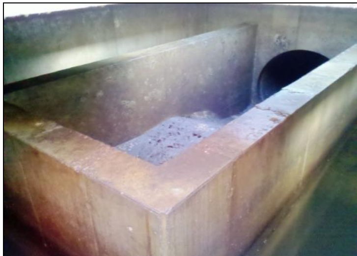
Foto 20: Interne overstort in rioolstelsel
